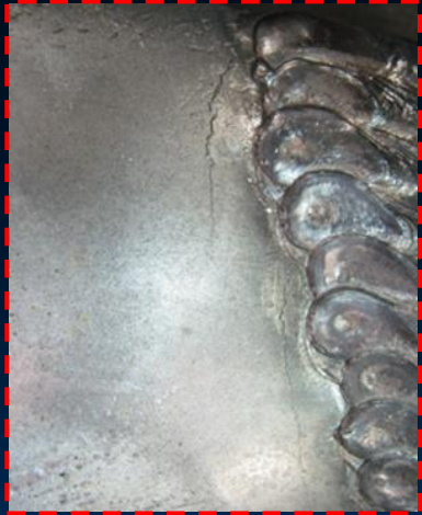
Heel Crack (EWI)
